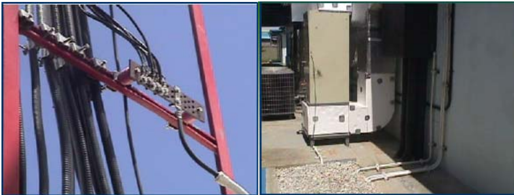
(a) Disposición de Cableados
